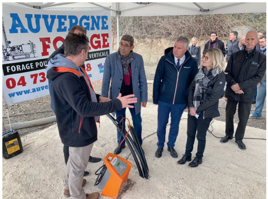
Le 31 mars dernier, forage de la dernière sonde du smart grid géothermique en présence des élus.
